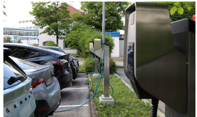
Ladesäulen für Elektromobilität im Werk. Quelle: Roche
