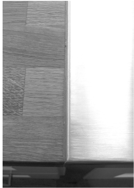
Silikonisauma puutasot ja ruostumattomasta teräksestä valmistetun keittiöaltaan välissä.
