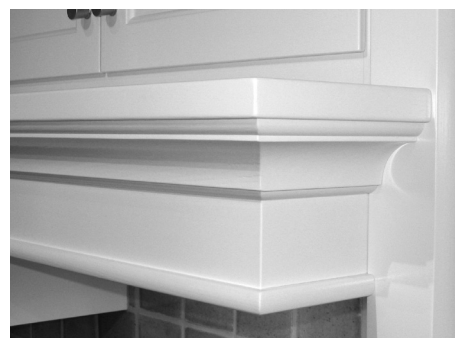
Detaljbild fläktkåpan Råbäck monterad mot pelare.
