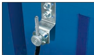
Point de mise à la terre chez le client
