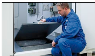
Plancher double avec trappe d'inspection pour l'équipement technique
