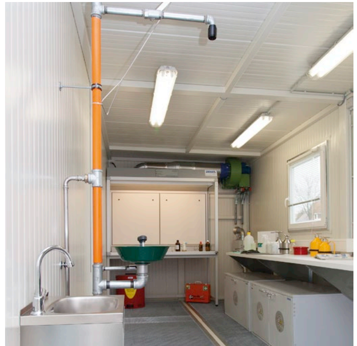
Salle d'échantillonnage avec poste de travail ventilé et douche d'urgence. Les armoires basses coupe-feu assurent une protection supplémentaire pour les échantillons de réinitialisation.
