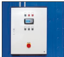
Armoire électrique pour un raccordement central
