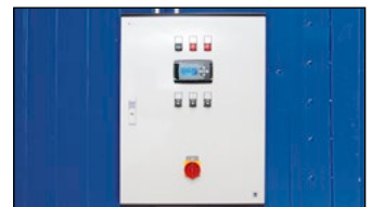
Armoire électrique pour un raccordement central
