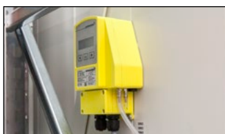
Contrôle d'extraction d'air
