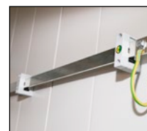
Rail de mise à la terre
