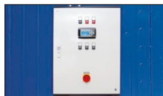
Armoire électrique pour un raccordement central
