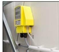
Surveillance de la sortie d'air pour un taux de renouvellement d'air de > 2,0/h
