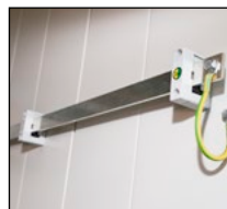
Rail de mise à la terre
