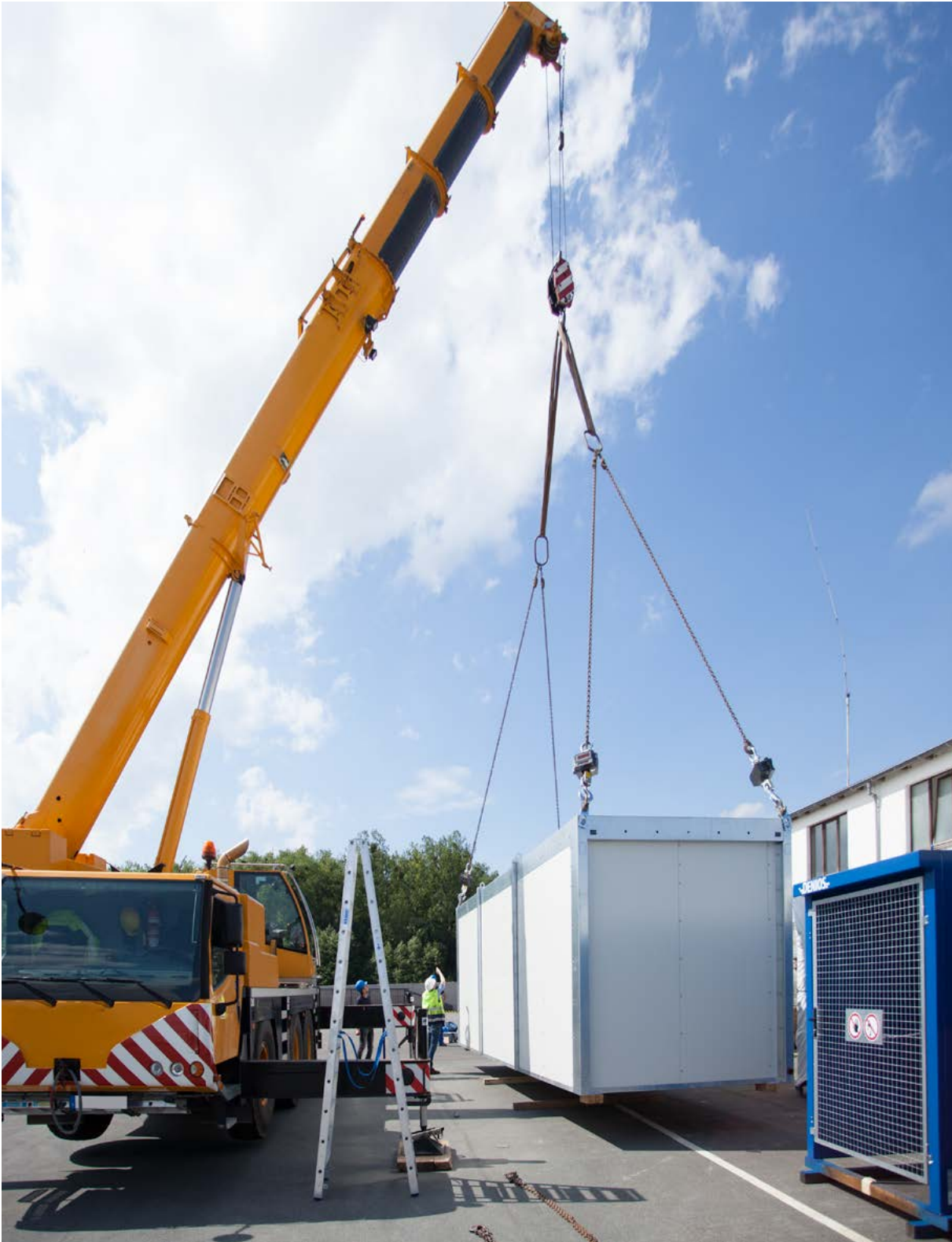
Voor de uitpandige opstelling van een warmtekamer wordt meestal een kraan gebruikt.
