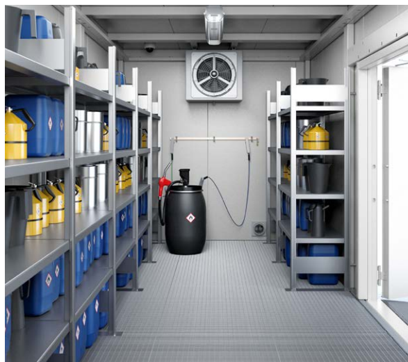
Vue intérieure du bungalow coupe-feu WFP avec dispositif de mise à la terre pour les fûts et pompes.
