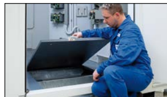
Doppelboden mit Revisionsklappe für Technik-Equipment
