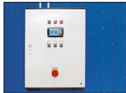
Schaltschrank zum zentralen Stromanschluss
