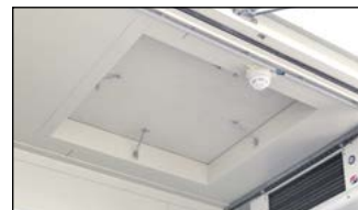
Druckentlastungsfläche im Dachbereich
