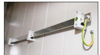
Erdungsschiene im Inneren des Raumsystems
