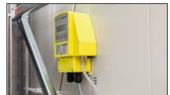
Abluftüberwachung bei Luftwechsel > 2,0/h
