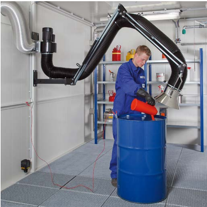
Umfüllraum mit integriertem Absaugarm für die punktuelle Absaugung gesundheitsgefährdender Dämpfe
