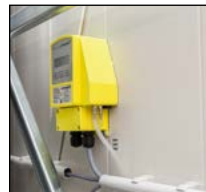
Abluftüberwachung bei Luftwechsel > 2,0/h
