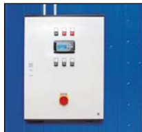
Schaltschrank zum zentralen Stromanschluss
