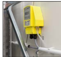
Abluftüberwachung bei Luftwechsel > 2,0/h
