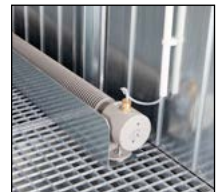
Rippenrohrheizung mit Anfahrerschutz
