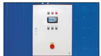
Schaltschrank zum zentralen Stromanschluss
