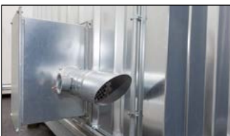
Technische Lüftung bei Isolierung
