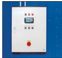
Schaltschrank zum zentralen Stromanschluss
