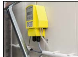
Abluftüberwachung bei Luftwechsel > 2,0/h
