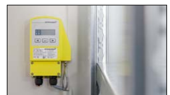
Technische Lüftung mit Abluftüberwachung
