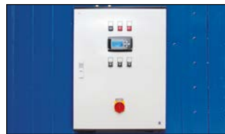
Schaltschrank zum zentralen Stromanschluss
