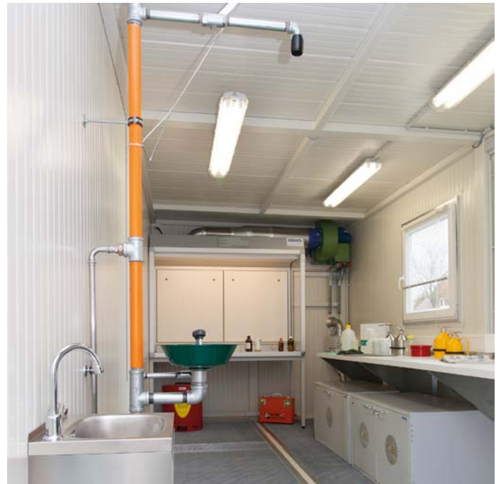
Beprobungsraum mit Lufttechnik-Arbeitsplatz und Notdusche. Zusätzliche Sicherheit bieten die brandgeschützten Unterbauschränke für Rückstellproben.
