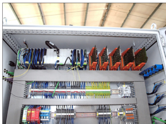
Obr. 5. Rozváděč IMM před rekonstrukcí (nahore) a po rekonstrukci s řídicím systémem Keba
