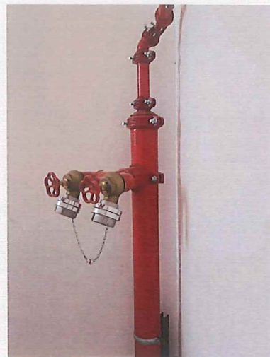
Sistema de proteção contra incêndios
