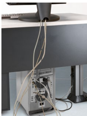
Sin organizador de cableado
