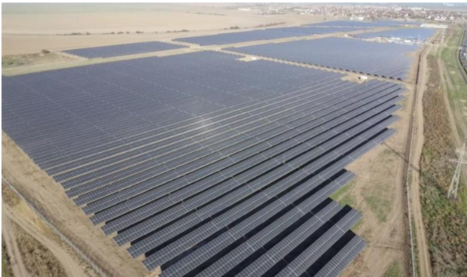
Die 40MWp Anlage der CCE Holding in Arad/ Rumänien. © CCE
