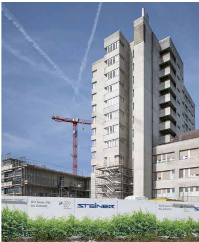
Der Neubau des Spitals Wetzikon machte Schlagzeilen. Die Steiner AG kündigte den Bauvertrag, obwohl das Gebäude noch nicht fertig war. BILD: KEYSTONE/CHRISTIAN BEUTLER
