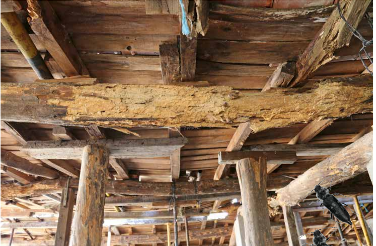
Befallene tragende Holzelemente
