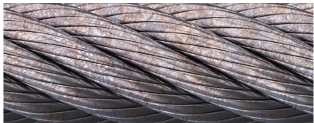
Abb.: Leichte Korrosion – 0 % - 20 % Schweregrad
