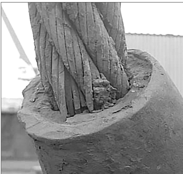
Abb. 3: Drahtbruch an einer Seilendverbindung
