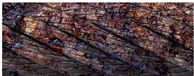
Abb.: Hochgradige Korrosion 80 % bis 100 % Schweregrad
