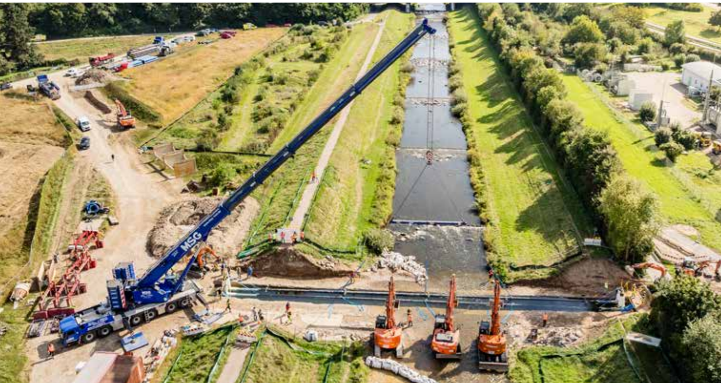
Querung der Dreisam für Fernwärme: Im Flussbett haben wir einen Graben ausgehoben, in den wir die Fernwärmeleitung mit einem Kran eingelegt haben. Die Arbeiten erfolgten im offenen Gewässerbetrieb und ohne ökologische Beeinträchtigung.
