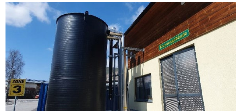
Abb. 21: Druckfilteranlage zur Enteisung und Entmanganung
