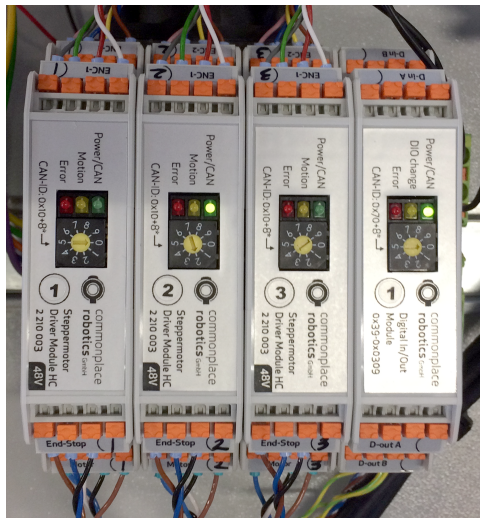
Abbildung 2: Drei Motormodule mit je 4 Steckern pro Modul, die zu je einem Motor und dem dazugehörigen Referenzsensor führen. Auch im Bild: ein Digitales I/O Modul (Modul rechts), welches nicht verdrahtet ist.
