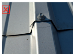
Obr. 53 – nedodržení postupu montáže
