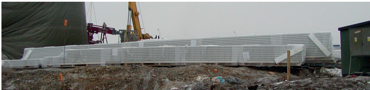
Малюнок 9. Неправильне зберігання панелей
