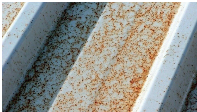
Малюнок 35. Пошкодження лакового покриття, спричинене залишками іржавих ошурків
