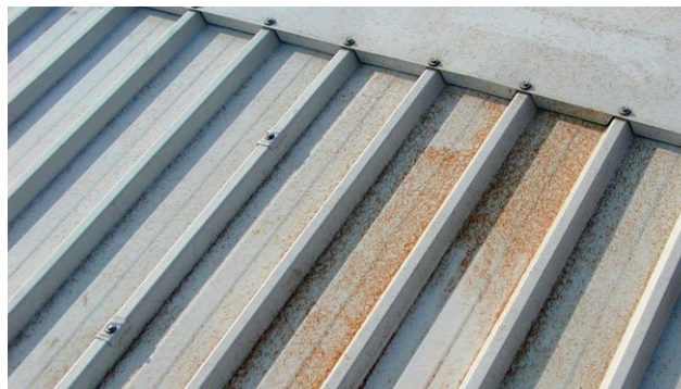
Малюнок 34. Вигляд лакового покриття, пошкодженого ошурками під час різання кутовою шліфувальною машиною
