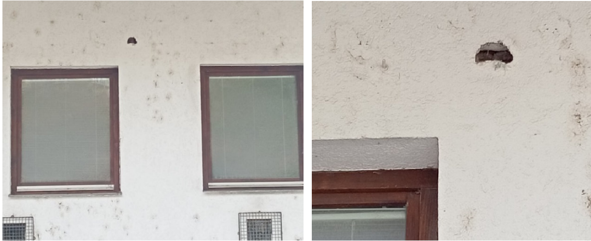
Abbildung 27: Potentielle Brutplätze an der „Lagerhalle“ zwischen Tor 15 und 16 mit Loch im Mauerwerk.
