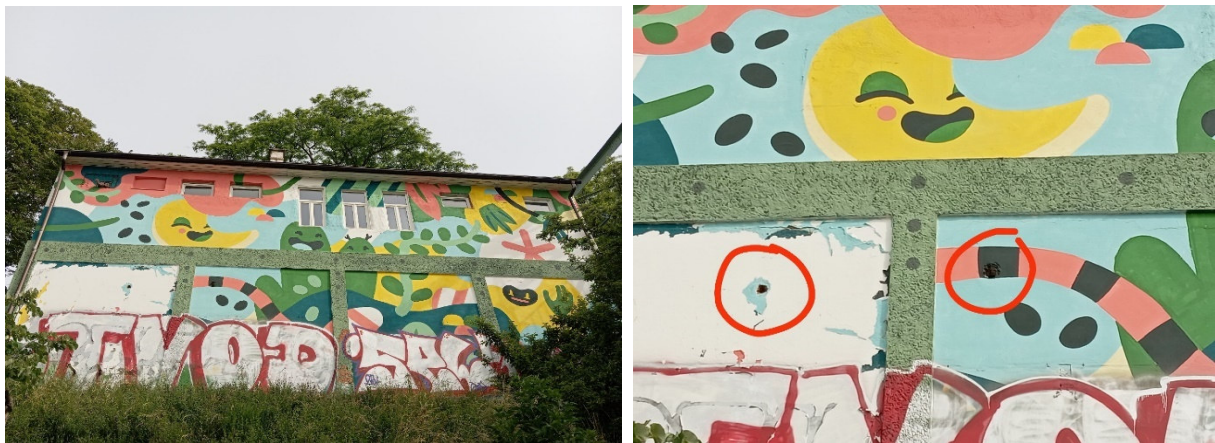
Abbildung 28: Rückseite des Gebäudes „Stadtraum Mitte 15“ auf der Westseite vom Rustensteg mit Löchern im Mauerwerk.
