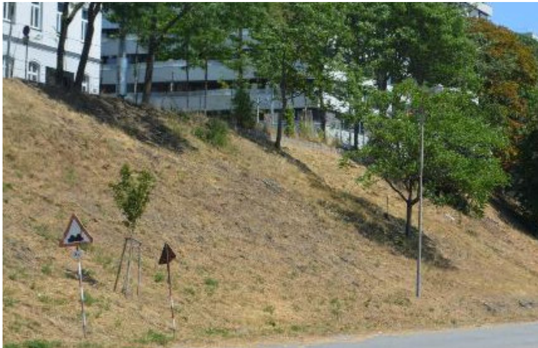
Abbildung 3: Nach einer späten Mahd Ende Juni, während einer Hitzeperiode zeigte sich fast die gesamte Böschung für mehrere Wochen sehr trocken und vegetationsarm (05.07.2025).
