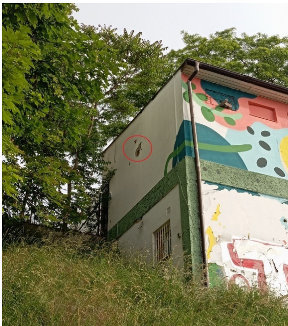
Abbildung 29: Seitenansicht des Gebäudes „Stadtraum Mitte 15“ auf der Westseite vom Rustensteg mit Löchern im Mauerwerk
