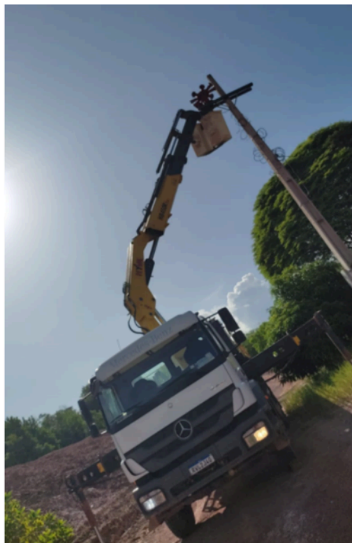
Figura 2 – Local de instalação da sirene.
