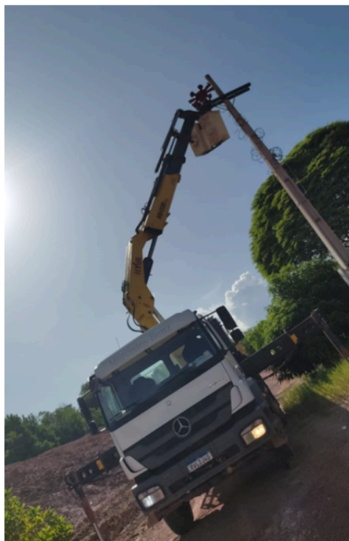
Figura 2 – Local de instalação da sirene
