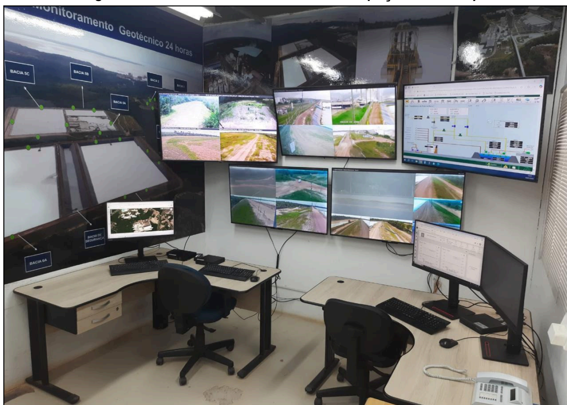
Figura 8-1 – Centro de Monitoramento e Inspeção da Artemyn.
