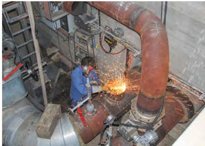
In fast fünf Metern Tiefe bereitet ein Vorrichter die Schweißnaht für den Einbau der Absperrarmatur vor.
