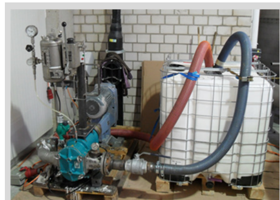
Testaufbau im Börger Pumpenprüfstand
