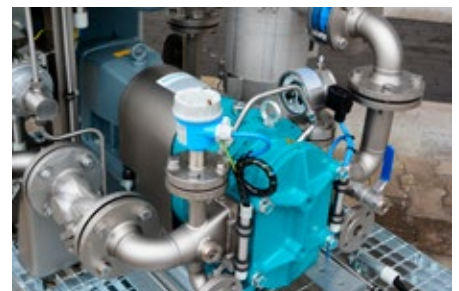
Druckmessung mittels Drucktransmitter
