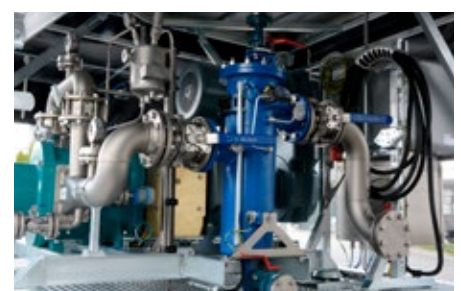
Filteranlage mit Differenzdruckmessung
