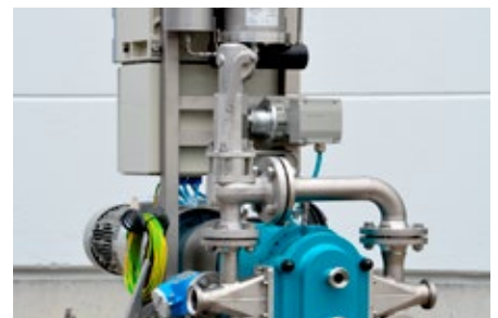
Überdruckschutz durch Bypass mit Sicherheitsventil
