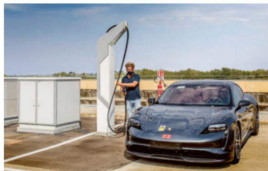
大功率充电: NTC 测试中心共有六个电动汽车快速充电站。
