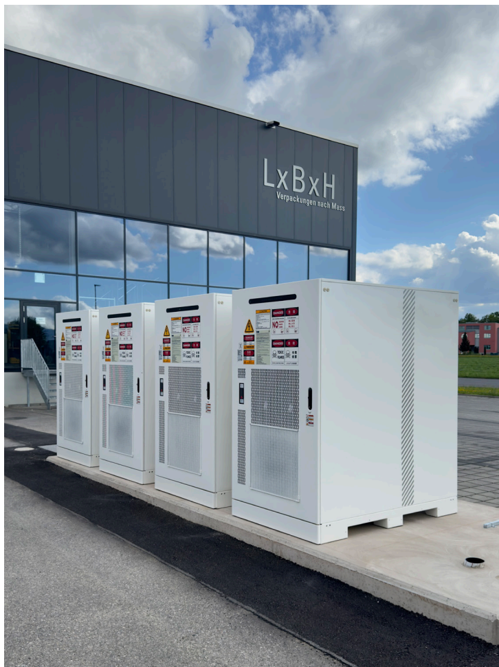
Der neue Batteriespeicher auf dem Firmengelände in Kirchberg BE.
