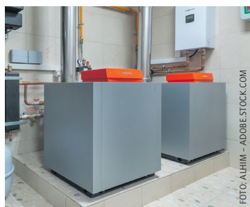
Heizkessel bis auf Weiteres im Fokus
