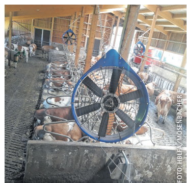
Ausreichend dimensionierte Ventilatoren im Liegebereich eignen sich bestens zur Minderung von Hitzestress.
