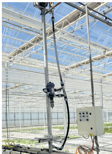
Die Bewässerung läuft abgestimmt auf die Sonneneinstrahlung.
