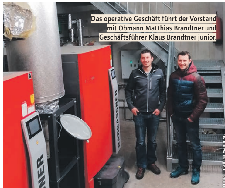
Das neue Heizwerk ist seit 2023 im Einsatz. Im Winter wird es zusätzlich vom alten Heizwerk unterstützt, im Sommer ist ausschließlich das neue Heizwerk in Betrieb.
