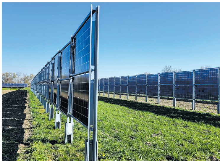
Vertikale bifaziale Module können auf beiden Seiten Strom erzeugen.
