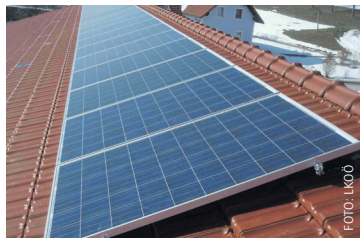
PV-Anlage auf Maschinenhalle
