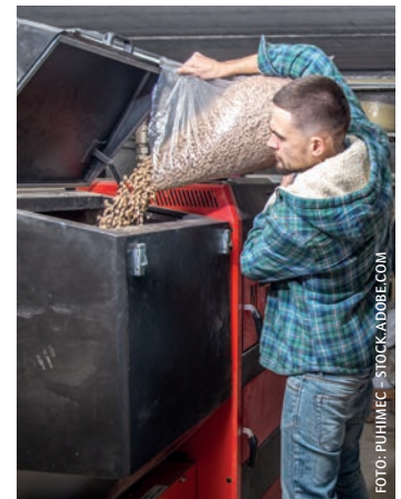
Holzheizungen entwickeln sich stark weiter.
