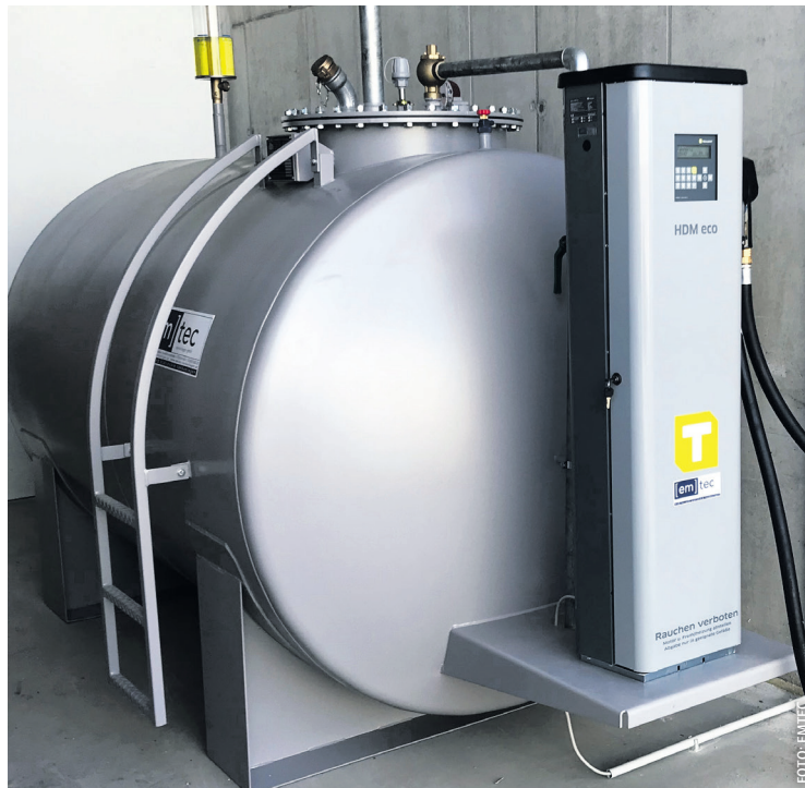
Ab 1.000 Liter Tankvolumen besteht Meldepflicht. Neue Dieseltanks müssen bei oberirdischer Verwendung die ÖNORM EN 12285-2 erfüllen.
