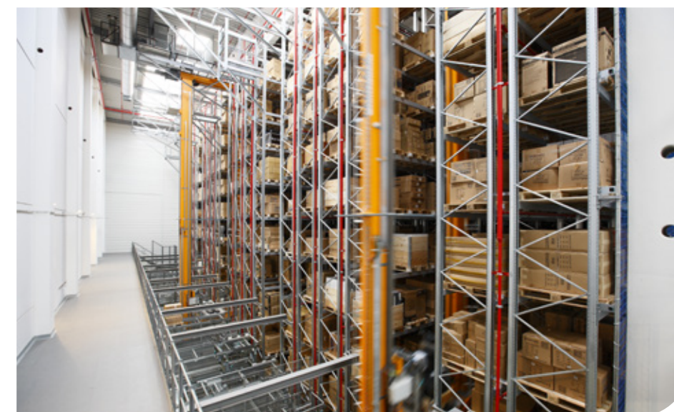
Neue und bestehende Anlage spielen jetzt harmonisch zusammen.
