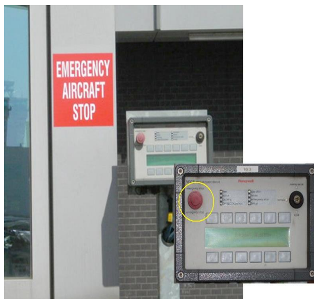
Fig. 53. DGS-noodstop pier A
