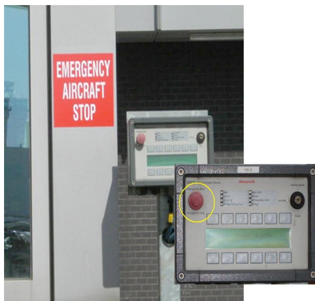
Fig. 52. DGS-noodstop pier A
