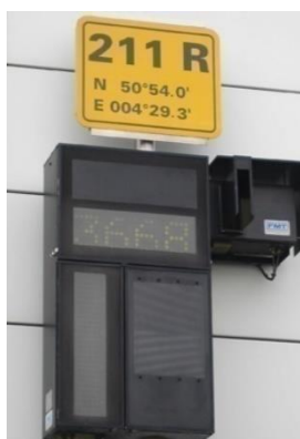
Fig. 50. Aanduiding DGS, tegen de gevel van pier A of pier B of op een paal (apron 3, apron 9 of apron 60)
