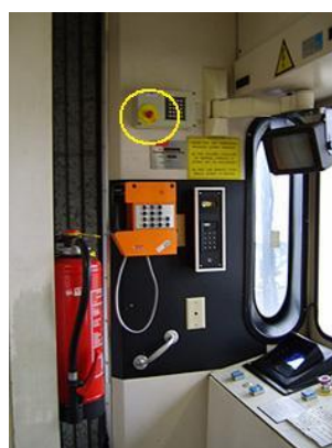
Fig. 54. DGS-noodstop pier B, in stuurcabine boarding bridge
