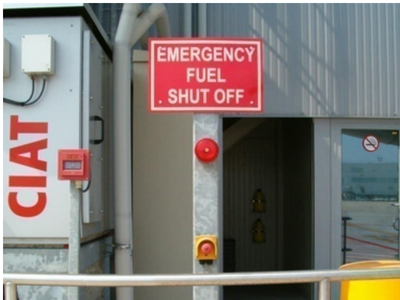
Fig. 58. Arrêt d'urgence hydrant de carburant
