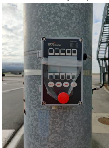
Fig. 56. Arrêt d'urgence Apron 3
