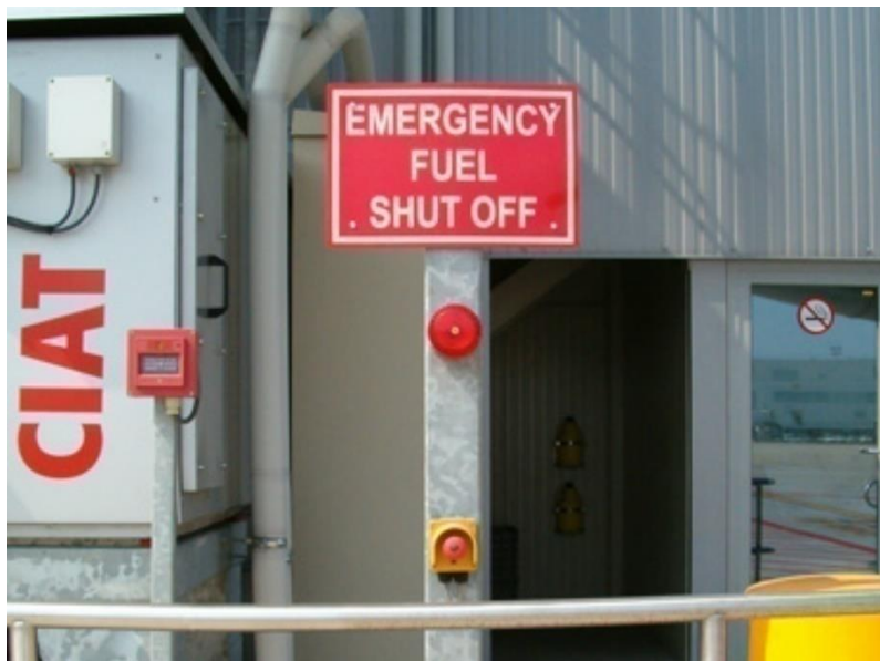
Fig. 57. Arrêt d'urgence hydrant de carburant
