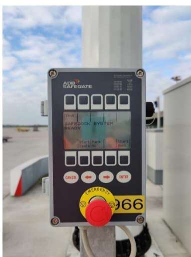
Fig. 55. Arrêt d'urgence apron 9
