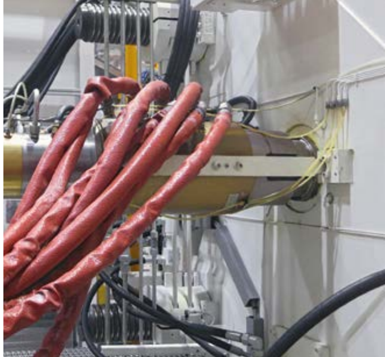
Aby doprowadzić wszystkie media, w tym wodę pod ciśnieniem dla potrzeb zmiennotemperaturowego termostatowania form przez ruchomą płytę mocującą i stół obrotowy, w ENGEL, specjalnie dla Faurecii, opracowano nowy przepust obrotowy.
