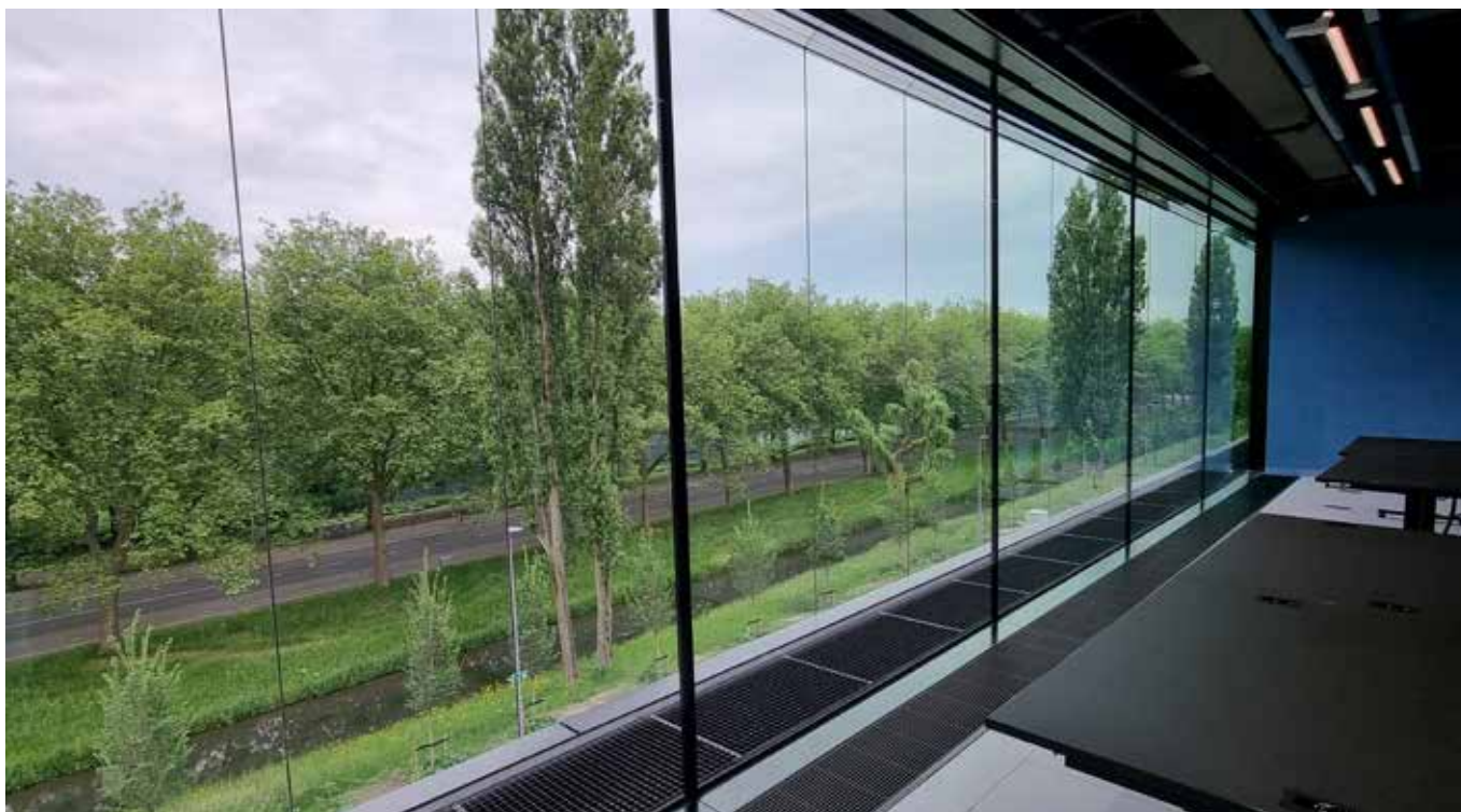
In moderne kantoorpanden met een glazen gevel wordt veelal gekozen voor vloerconvectoren.
