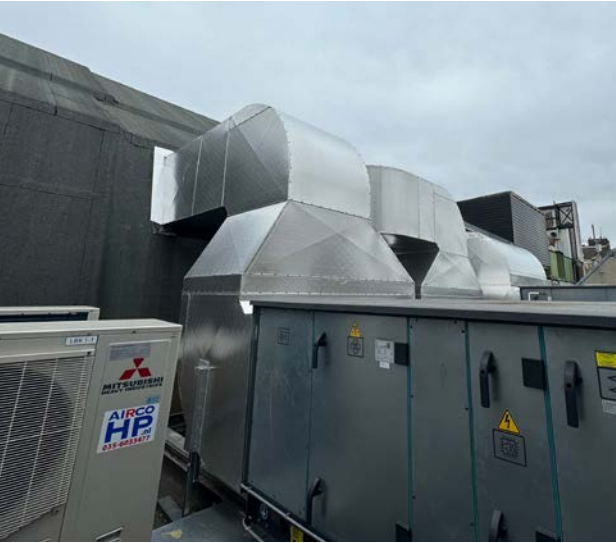
Bijvoorbeeld de grootste luchtbehandelingsunit is gedraaid opgesteld ten opzichte van zijn voorganger, zodat minder dakkanaalwerk nodig was.
