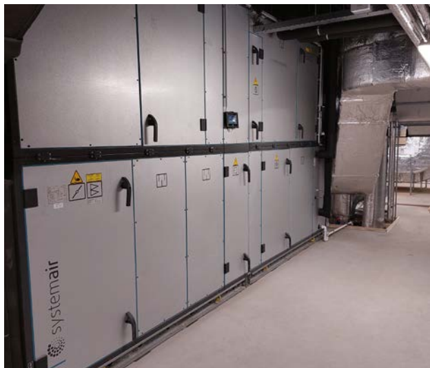
Vanwege de houten gebouwconstructie én om een hoogwaardig aanzicht te borgen, zijn alle luchtbehandelingsunits inpendig opgesteld in de technische ruimte.
