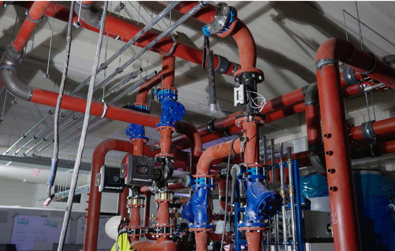
De installaties zijn op bezetting gestuurd, de temperaturen worden geregeld en gemonitord en er is rekening gehouden met een aangename akoestiek.
