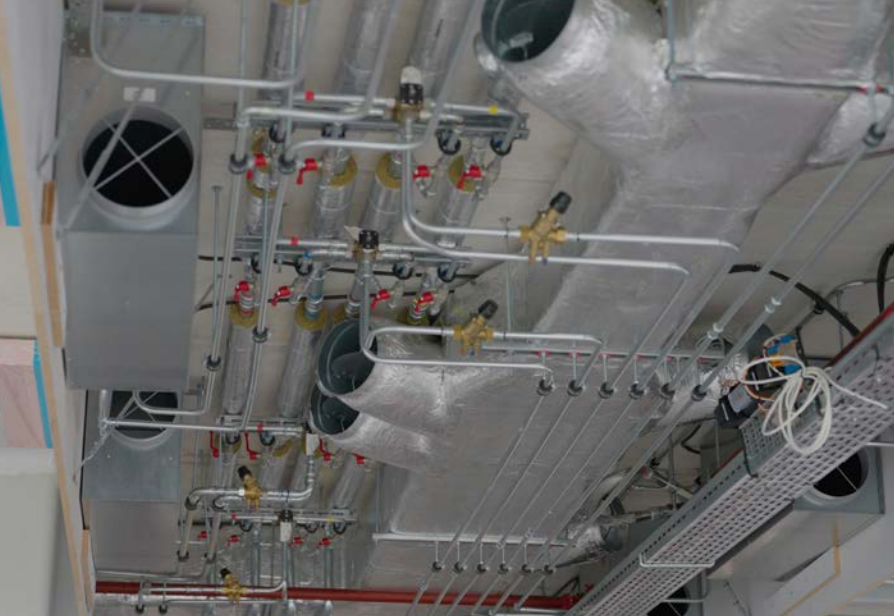
De installatietechniek speelt een hoofdrol binnen de verduurzaming.
