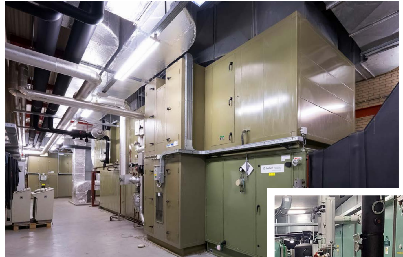
Het vervangen van indirect aangedreven ventilatoren door moderne frequentieregelbare elektromotoren met frequentieregelaars of toerengeregelde EC-ventilatoren kan een zodanig grote energiebesparing opleveren, dat de investeringskosten hiervan binnen een à twee jaar al zijn terugverdiend.
