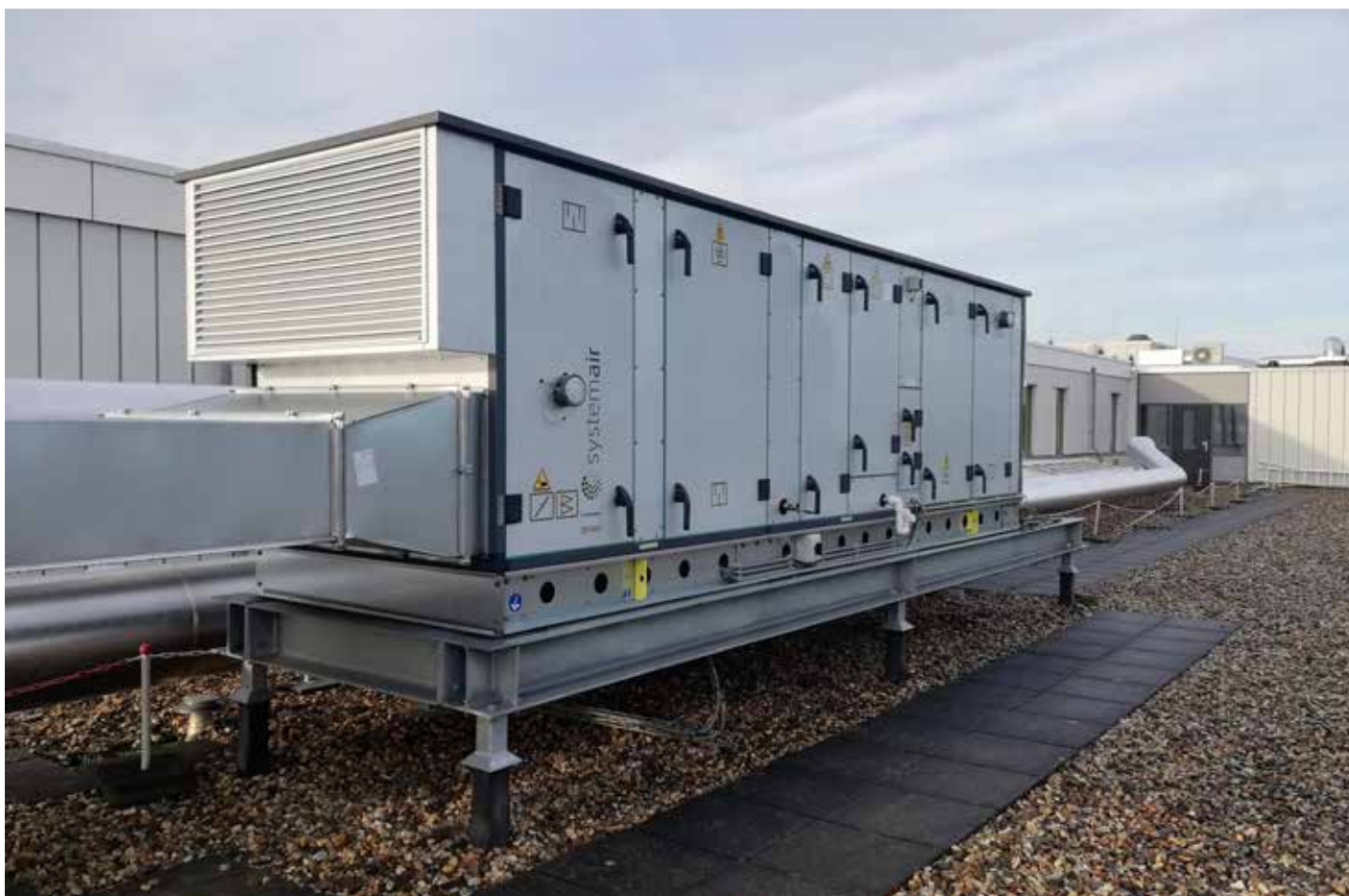
Frank Molenaar is enthousiast over de drie Geniox luchtbehandelingsunits die buiten op het dak opgesteld staan. “Wat opvalt is dat ze zo stil functioneren.”
